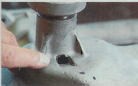
Noch ganz dicht? An der Unterseite jeder Wasserpumpe findet sich ein Leckloch
